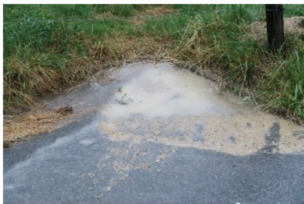
Wasser drückt aus Schlammsammler
